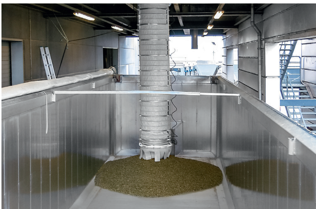
Offene Verladung: mit steigendem Schüttkegel hebt sich der Auslauf automatisch an.
